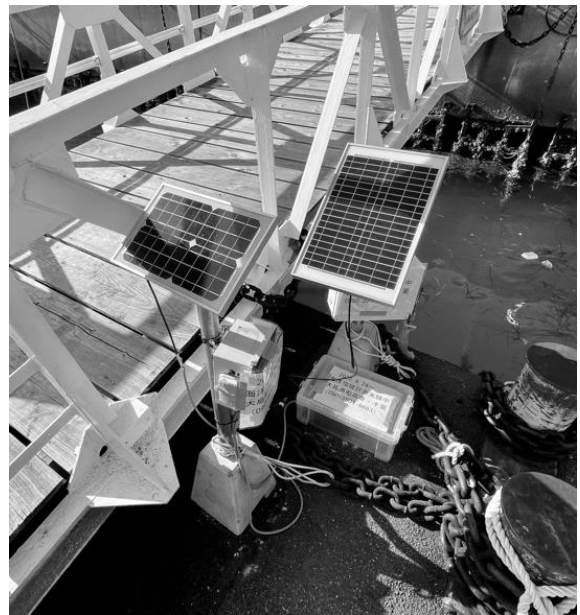
図5 浮棧橋付近のノード設置状況
