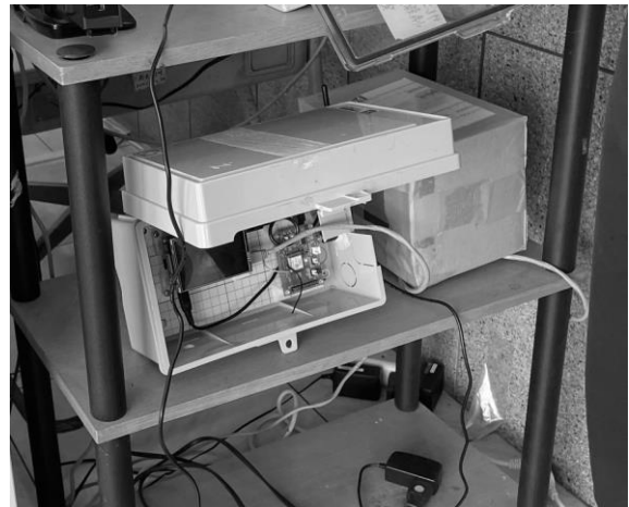
図10 伊保田港付近（陸奥記念館）における基地局の設置状況
