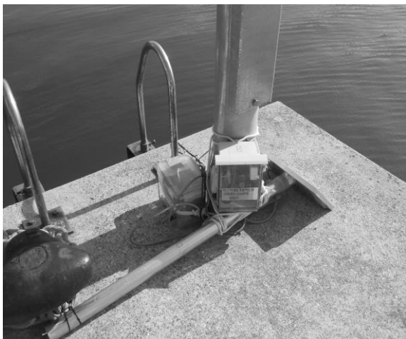
図4 周防大島でのノード設置状況
